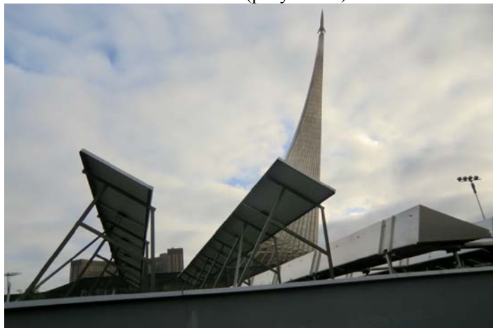
Рисунок 27 – Вид на фотоэлектрическую станцию со стороны ВДНХ
